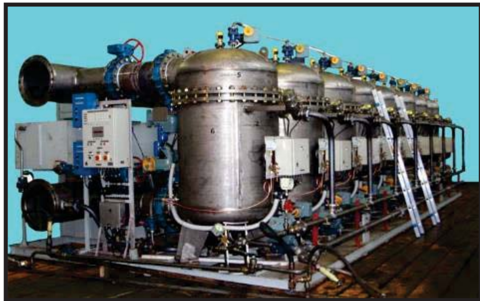
Figura 13. Sistema de filtrado presurizado
