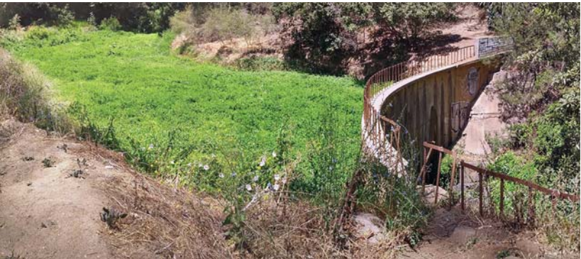
2do desarenador. Se encuentra al final de un sendero inhabilitado, por lo que se presta prácticas inseguras.
