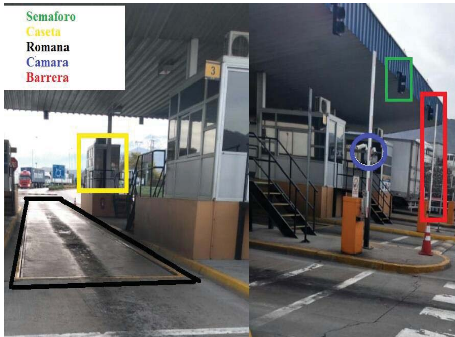
Figura 4.7: Elementos del gate-control del PTLA Fuente: Elaboración propia, obtenida en PTLA, 2019
