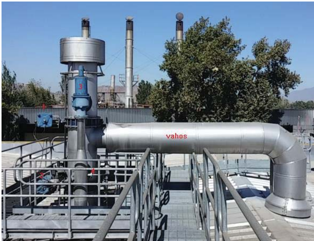
Figura N°29. Chimenea del cocedor de mosto.
