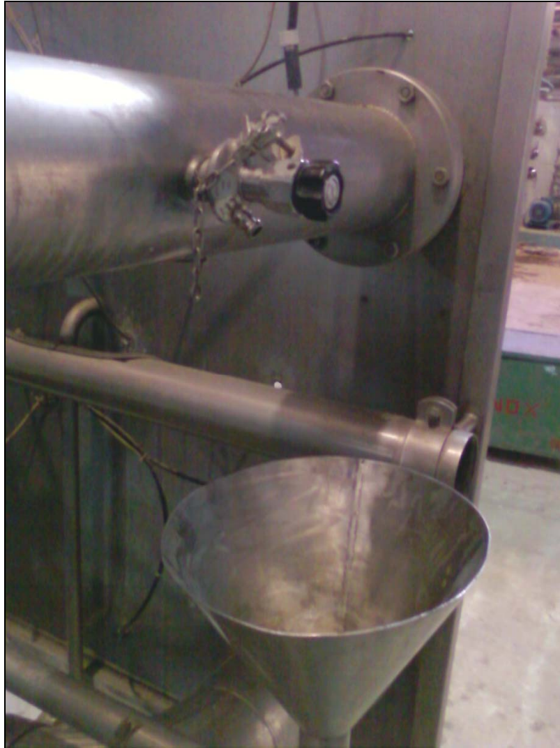
Fig. 5.1 Tomamuestra de Mosto Después del Intercambiador de Placas.
