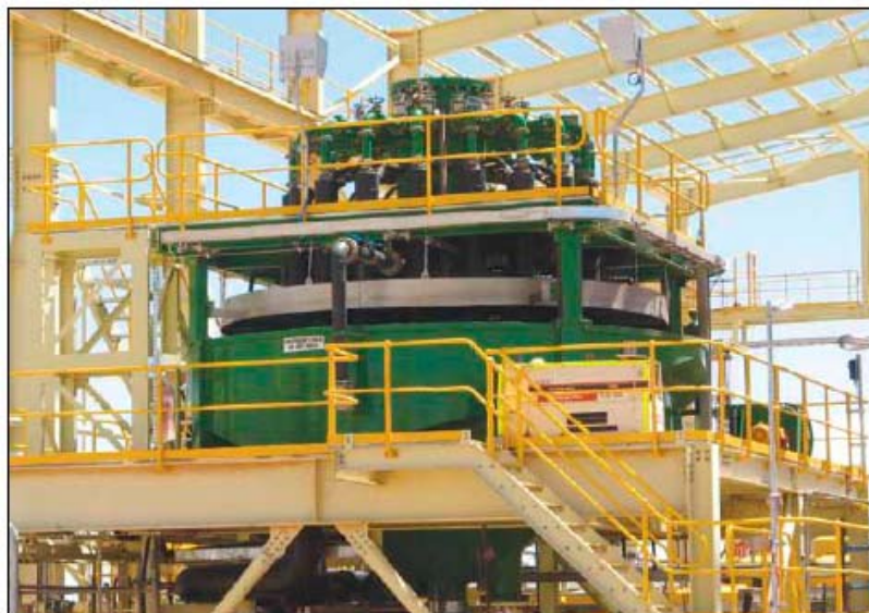
Figura 2-9. Celda Jameson en flotación de cobre previa a la limpieza en Prominent Hill, Australia
