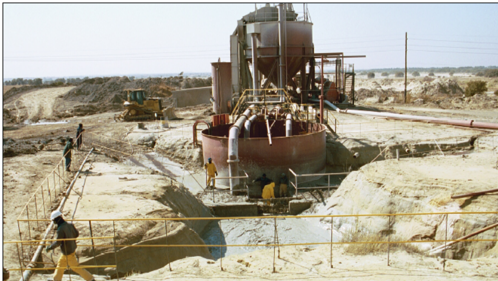
Figura 5-40. Estación de bombeo de Pulpa (SSP)
