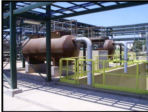
Figura 4. Separadores de aceites L-3603 A/B.
