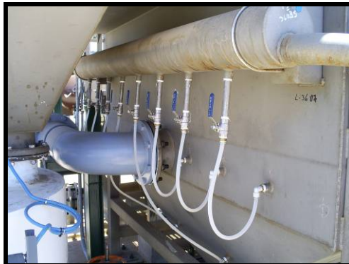
Figura 10. Recirculación de agua saturada de aire.
