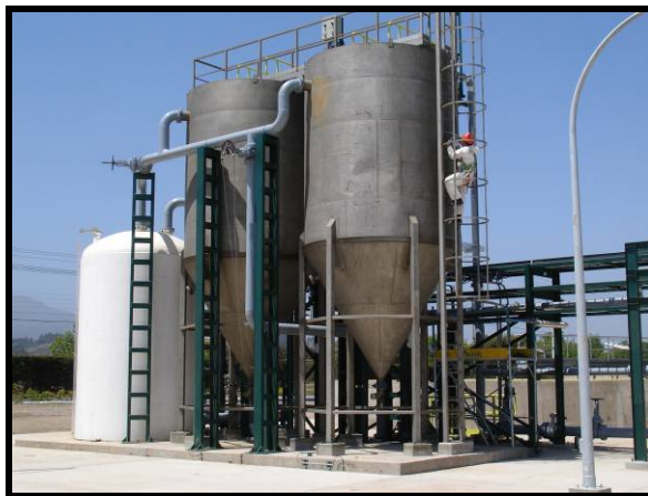
Figura 21. Filtros de arena L-3614.
