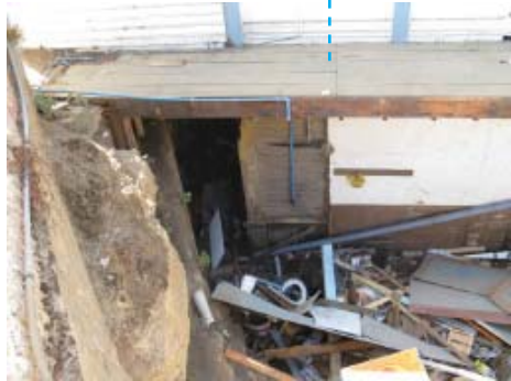
IMG.20 daños y pertenencias a la vista
