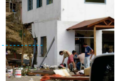
IMG.06 daños evidentes casas inundadas
