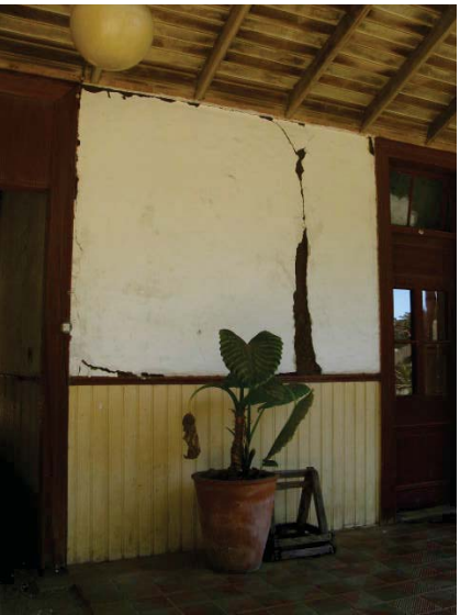
IMG.12 grieta en adobe de estuco
