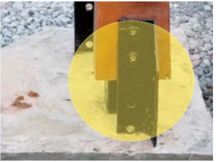
la fijación con una pletina y tuercas, que llegan a una fundación de hormigón que queda en altura, se levanta 10cm
