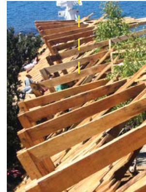
IMG.13 estructura con movimiento
