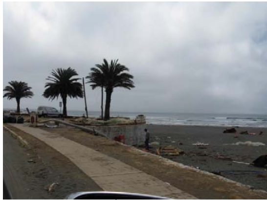
IMG.12 daños en balastradas
