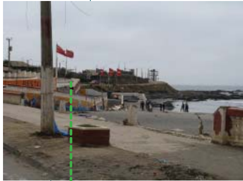
IMG.14 daños sector costero
