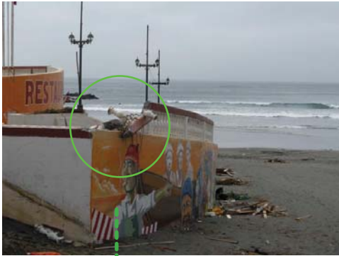
IMG.15 daños caleta de pescadores
