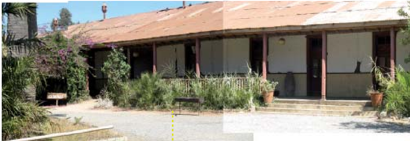
IMG.08 sector dañado por el terremoto
