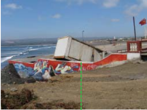
IMG.19 caleta de pescadores y sus daños a la vista
