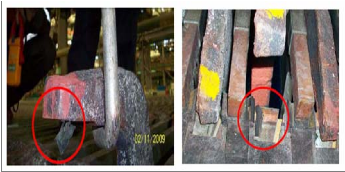
Figura 4- 18: Operación de celdas de refinación con ánodos aislados por grandes trozos de capping board de goma entre ánodo y barra conductora.
