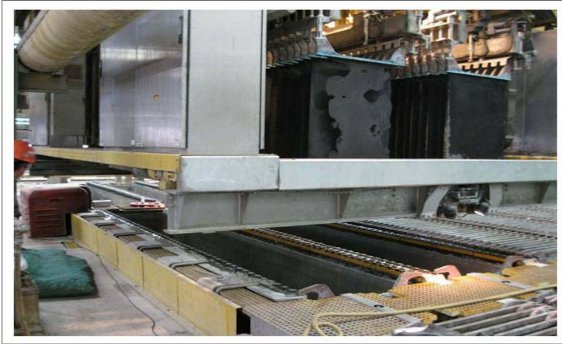
Figura 4- 13: Vista de Semisección 14-1B con barras intercelda Multicircuitales diseño Optibar 2.0 en operación en Refinería N° 2, Codelco Norte.
