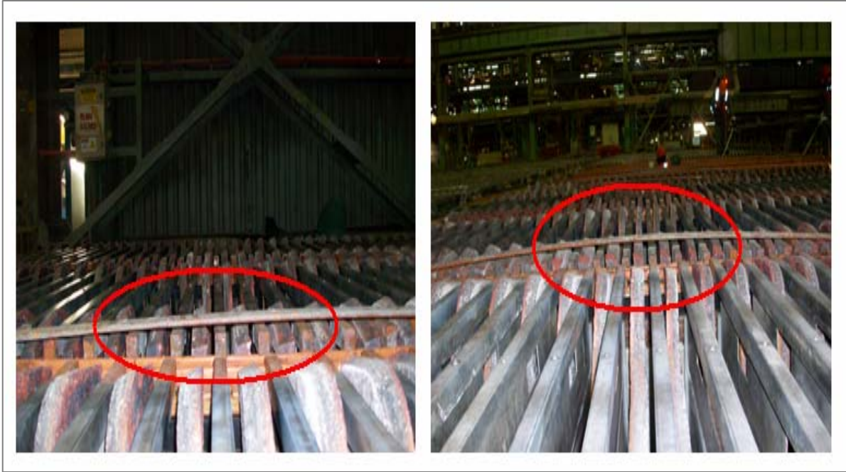
Figura 4- 11: Problemas de expansión de las barra multicircuitales instalados en la semisección 14-1A debido a los constantes cambios en la temperatura.
