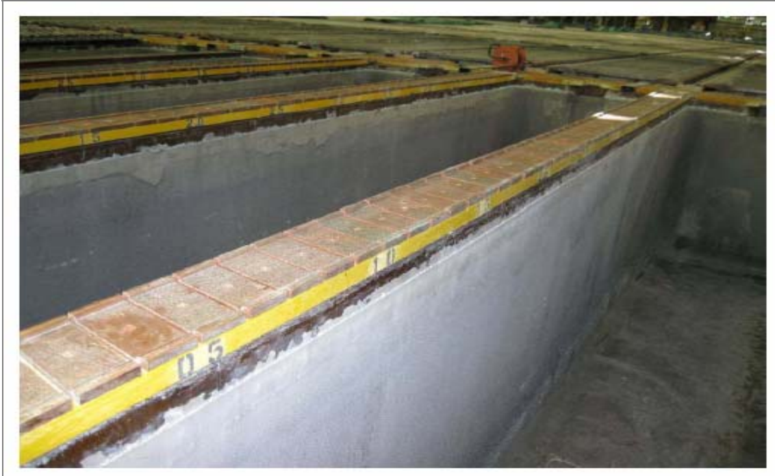
Figura 4- 11: Barras intercelda de Conexión Multicircuital diseño Optibar 2.0 instaladas en 20 celdas de semisección 14-1B en Refinería N° 2, Codelco Norte.
