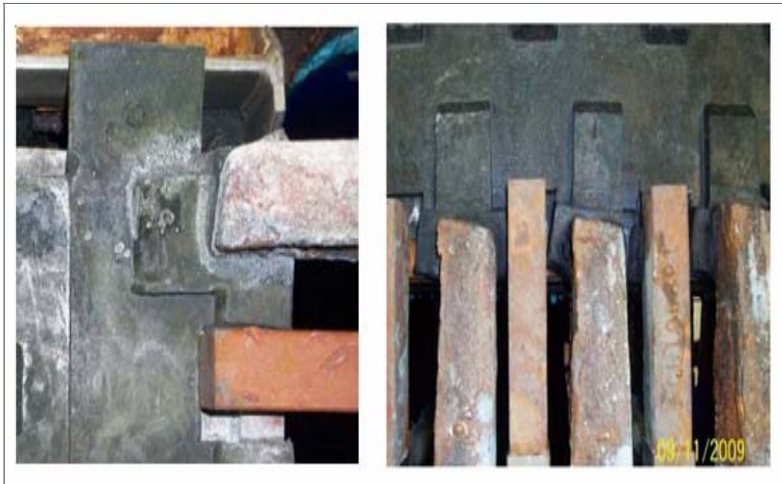
Figura 4- 16: Pérdida de características de diseño capping board de goma.: Deformación por efecto del peso de los ánodos y la temperatura.
