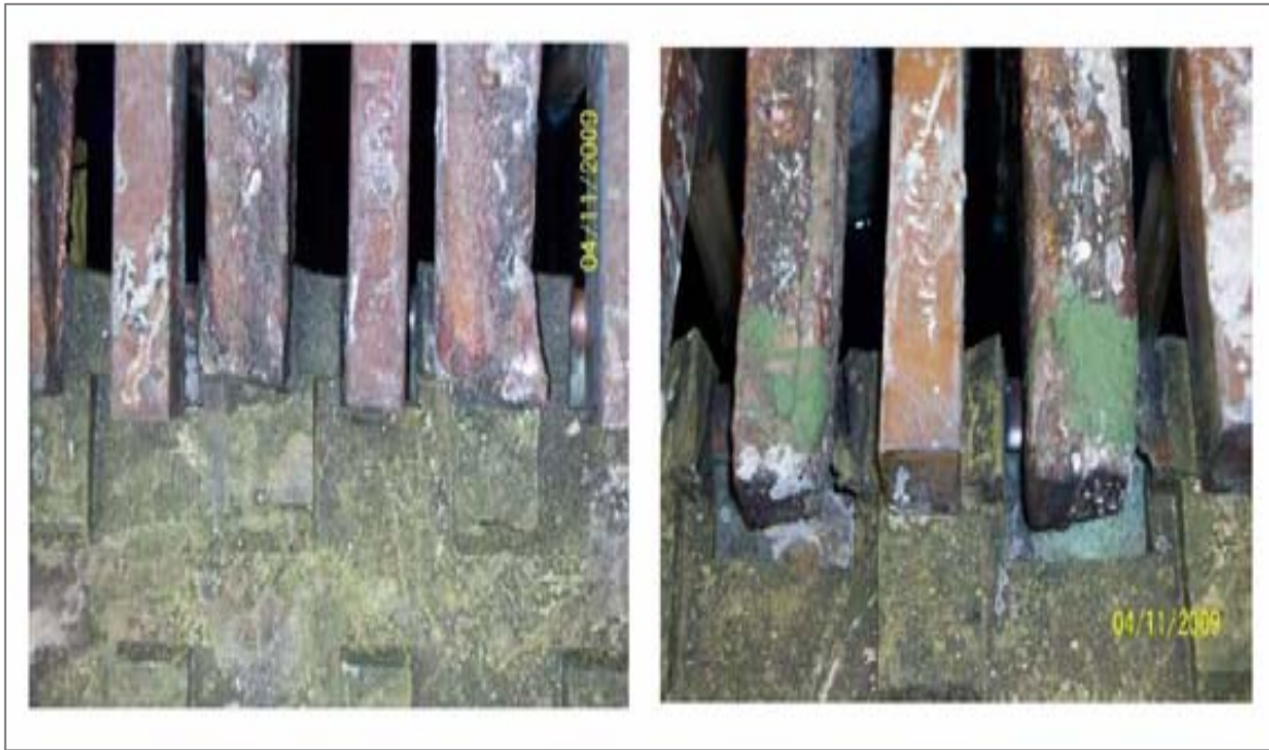
Figura 4- 15: Pérdida de características de diseño capping board de goma: Descomposición de goma-efecto sobre contactos de cátodos y barra conductora.
