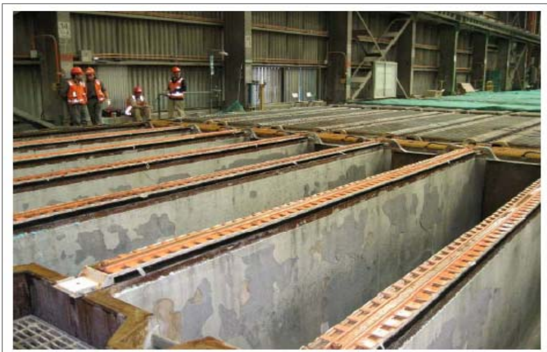
Figura 4- 2: Barras intercelda de conexión Multicircuitual diseño Optibar 1.0 instaladas en 20 celdas de la semisección 14-1A en Refinería N° 2, Codelco Norte.
