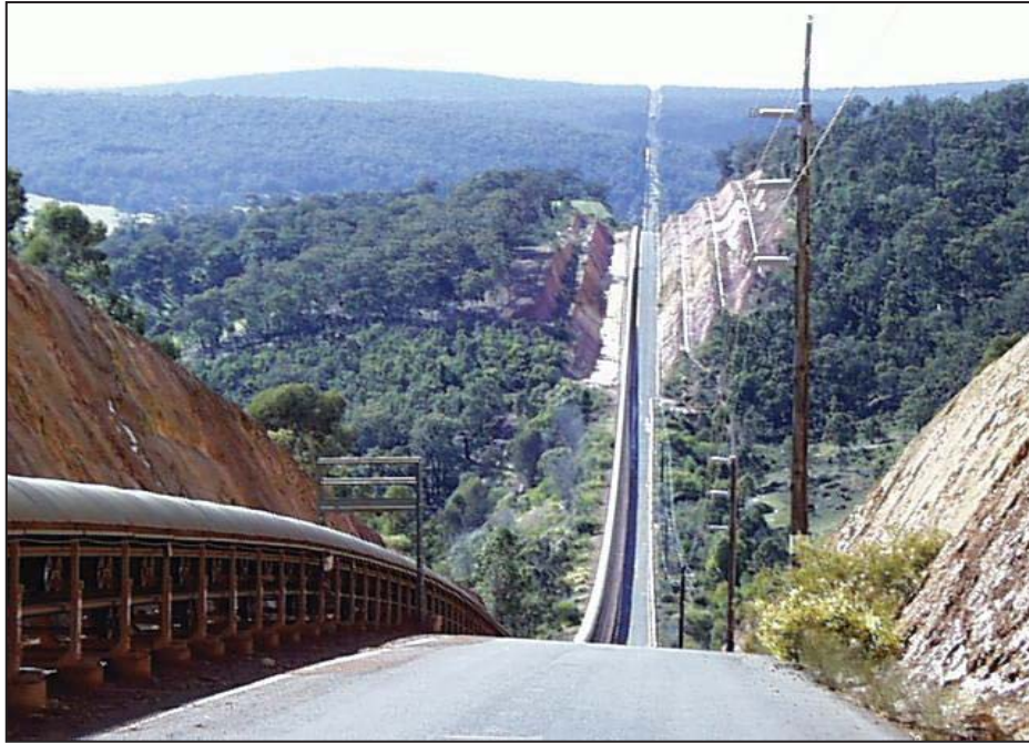
Figura 6-2. Instalación de MRC en Worsley Alumina Australia, largo correa 51,4 km
