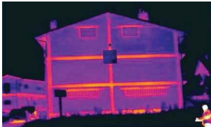
Figura 37. Puentes térmicos en cámara termográfica. Fuente: Ecohouses.es
