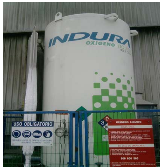
Figura 34: Estanque de almacenamiento de Oxígeno líquido.
