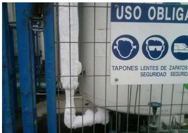
Figura 35: Efecto producido en las cañerías por bajas temperaturas del Oxígeno.
