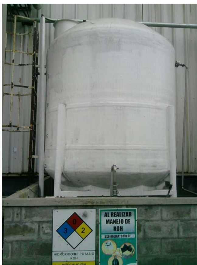
Figura 29: Estanque de almacenamiento exterior de KOH.
