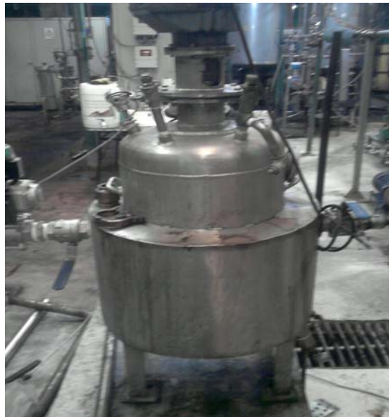
Figura 16: Vista frontal del equipo a modificar (Reactor Batch con chaqueta).
