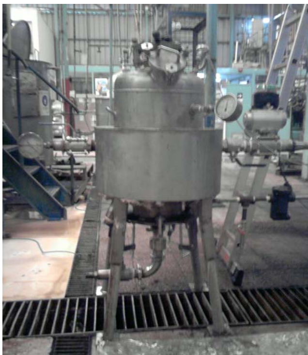
Figura 18: Equipo piloto terminado, según las modificaciones realizadas y listas para ser utilizado.
