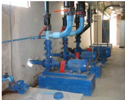
Figura 9. Sala de bombas.
