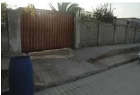
Desnivel no cumple con porcentaje de pendiente (8% requerido) y no llega a ras del nivel de la calle.
