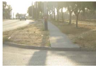
Sin desnivel a ras del nivel de calle. No cumple con ancho mínimo.
