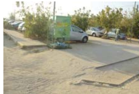
Bordes sin desnivel ni señalización (color)
