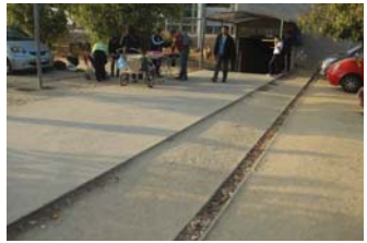
Canaletas descubiertas y sin señalar (color)
