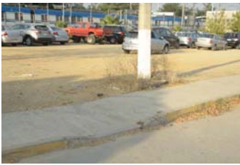
Desnivel no llega a ras del nivel de calle.
