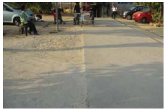
sin pavimentar, no estan a nivel.
