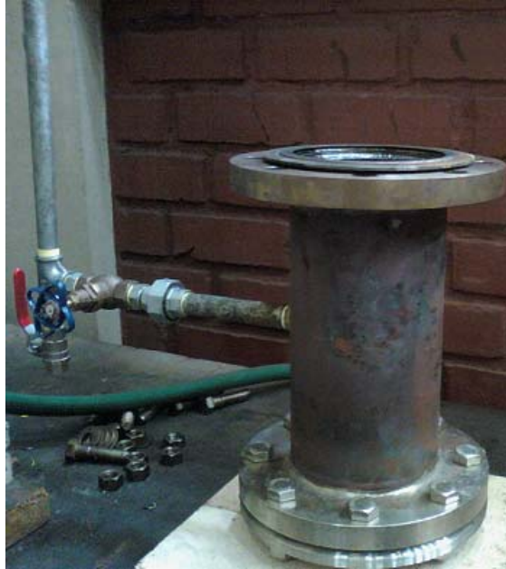
Figura 4.1: Cañerías de conexión de vapor.
