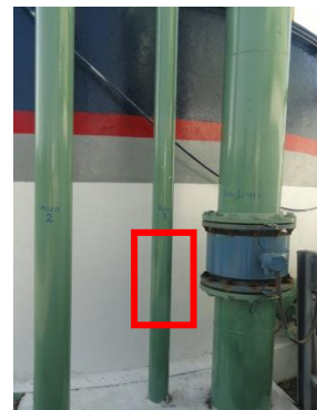
Descarga Pozo 3 Melón
