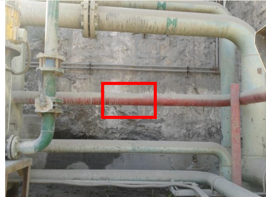
(2) Entrada Red Incendio
