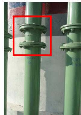
Descarga Pozo 6 Melón
