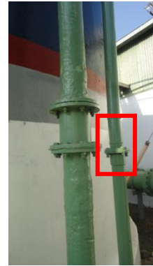
Descarga Pozo 1 Melón
