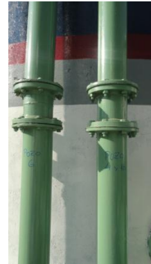
Descarga Pozo 4 Melón
