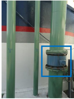
Flujómetro Pozos Los Litres
