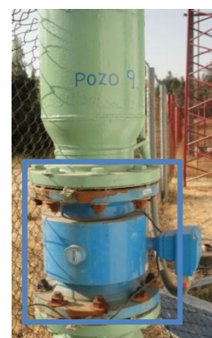
Flujómetro Pozo 9 Melón
