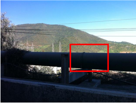
(5) Agua servicio desde Estanque SAG
