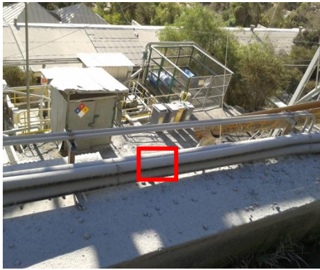
Línea alimentación Estanque Agua Potable
