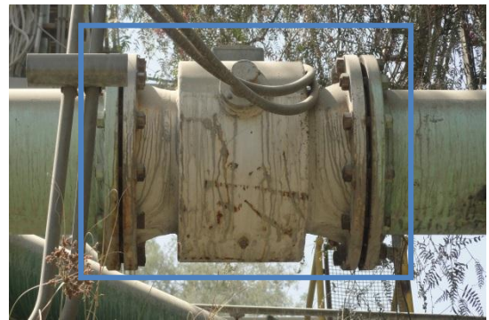
Flujómetro descarga bombas KSB.
