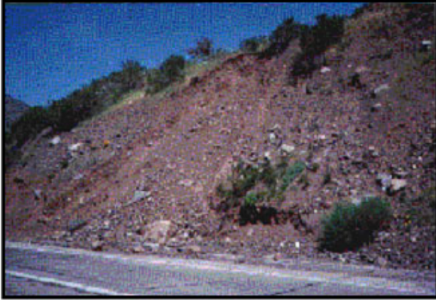
Figura 3.1. Vista de desplazamiento de suelos que caen en sector de Vizcachas en Ruta 60-CH.
