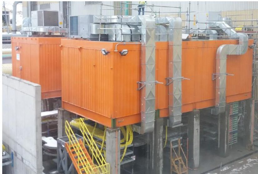
Figura 2-2. Sala eléctrica, e-house, Compañía Minera Doña Inés de Collahuasi.
