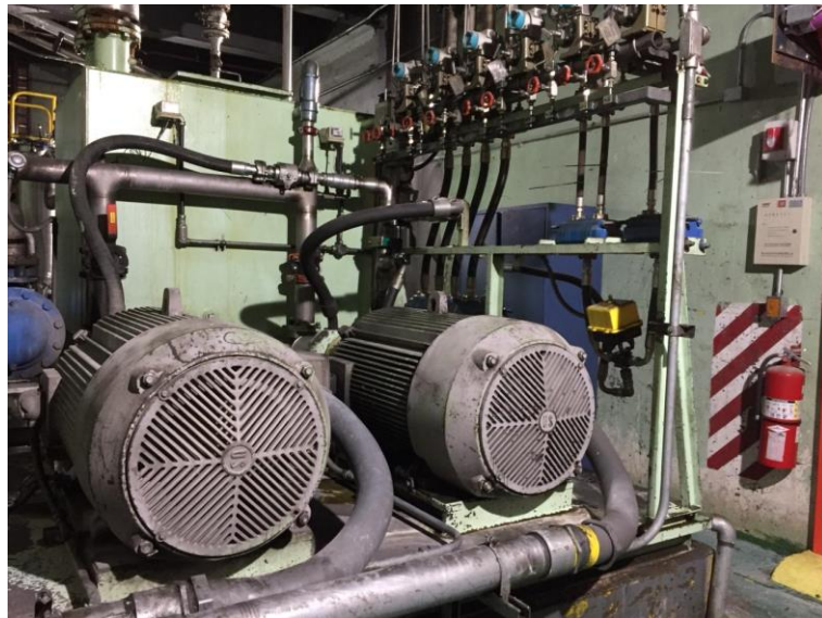
Figura 2-6: Bombas de alta presión, sistema de lubricación.
