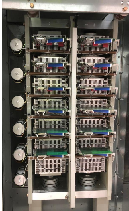
Figura 2-17: Cicloconvertidor trifásico que alimenta una fase del motor, Compañía Minera Doña Inés de Collahuasi.
