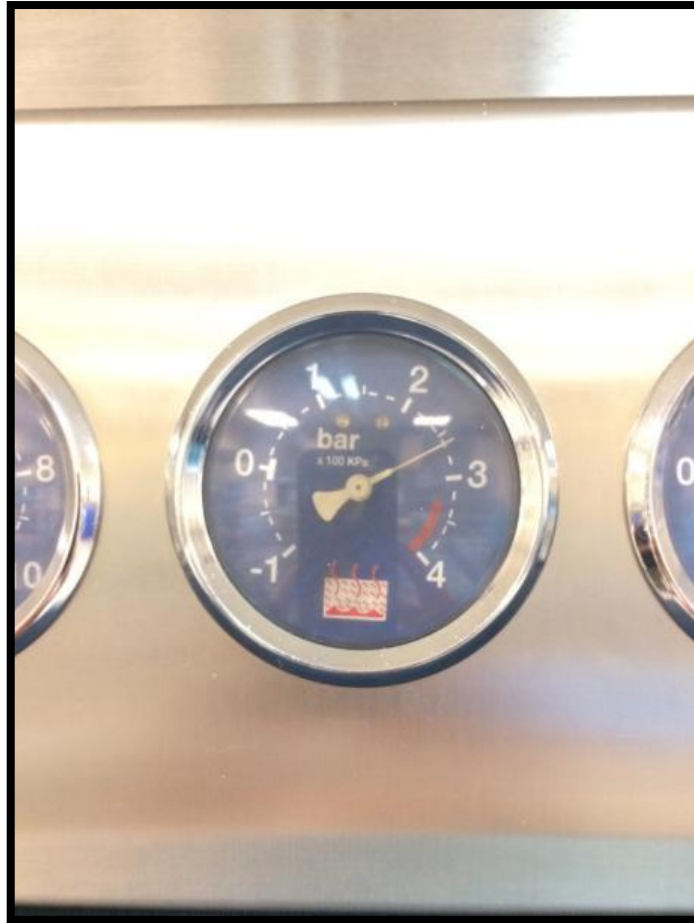
Figura 37: Mantenimiento Trimestral - Segunda Acción
