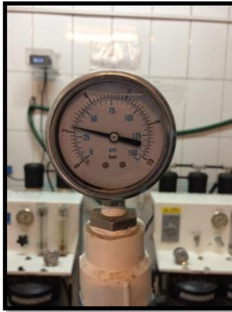
Figura 38: Mantenimiento Trimestral - Cuarta Acción
