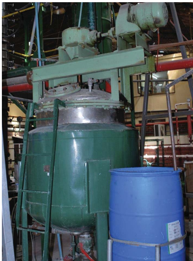
Figura 43. Reactor disponible en el laboratorio de operaciones unitarias.
