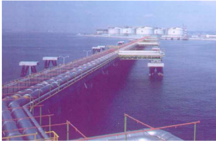
Fig. 3.3: Tuberías de descarga
