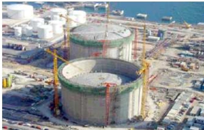
Fig. 2.4: Planta de regasificación de gas natural – estanques de almacenamiento
