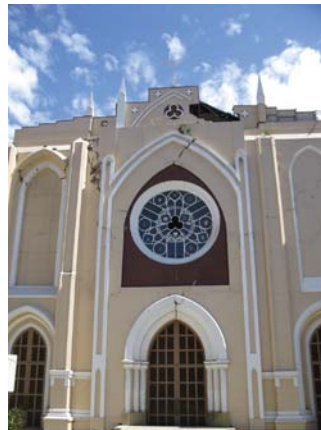
IGLESIA DE LOS 12 APOSTOLOS, Av. Argentina, La iglesia dañada por el terremoto 2010
