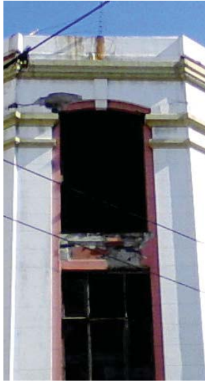
Daños de la ventanas
