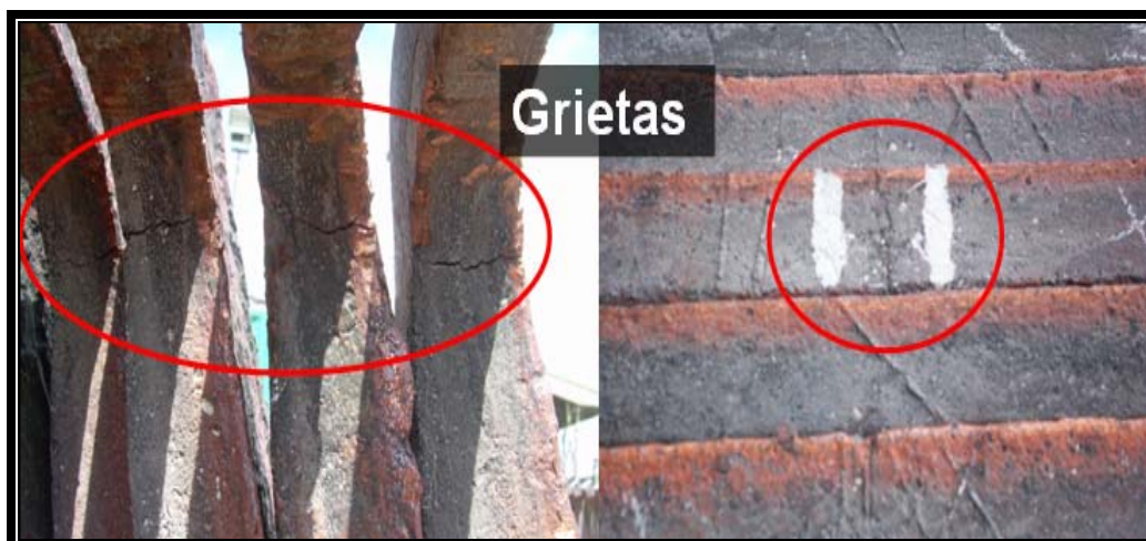
Fig. N°1. Grietas bajo las orejas y en el cabezal.
