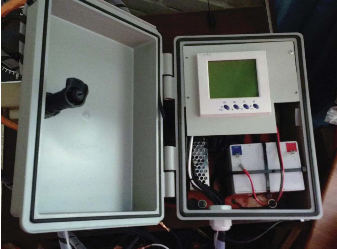
Figura 3-1 Estructura física del terminal remoto
