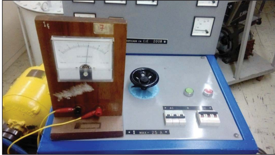
Figura A-17: Amperímetro para verificar la corriente en el Estator de la máquina.
