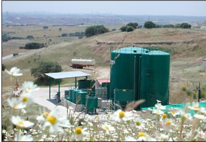
Figura 4.8 Silos de Compostaje
