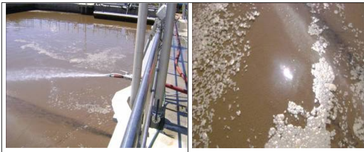
Figura 5-26 Imágenes después de la aplicación de antiespumante.
