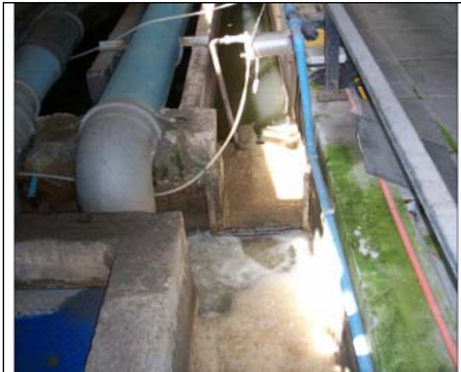
Figura 6-5 Espuma superficial en el efluente.
