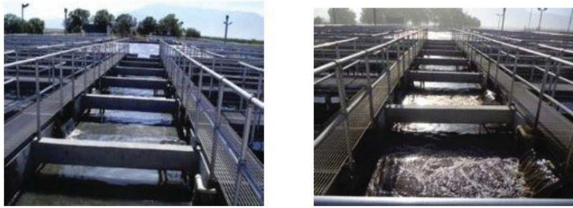
Figura 3-3: Estanque selector de lodos (fuente: http://www.mop.cl )
