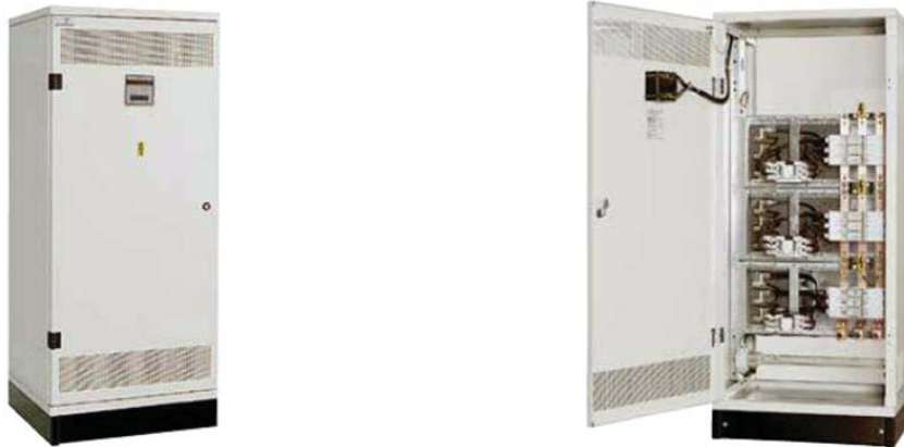
Figura 4-17: Banco de condensadores con controlador de factor de potencia (fuente: http://www.legrand.cl/ )
