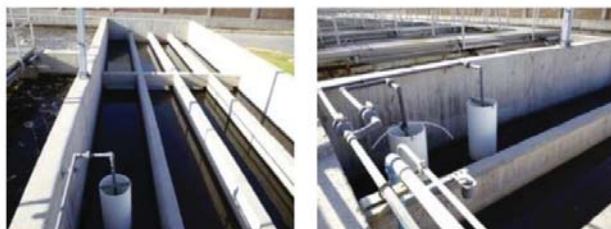
Figura 3-12: Cámara de contacto y punto de dosificación cloro gas (fuente: http://www.mop.cl )
