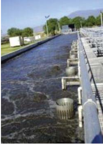
Figura 1-5: Planta de aguas servidas (fuente: http://www.mop.cl )
