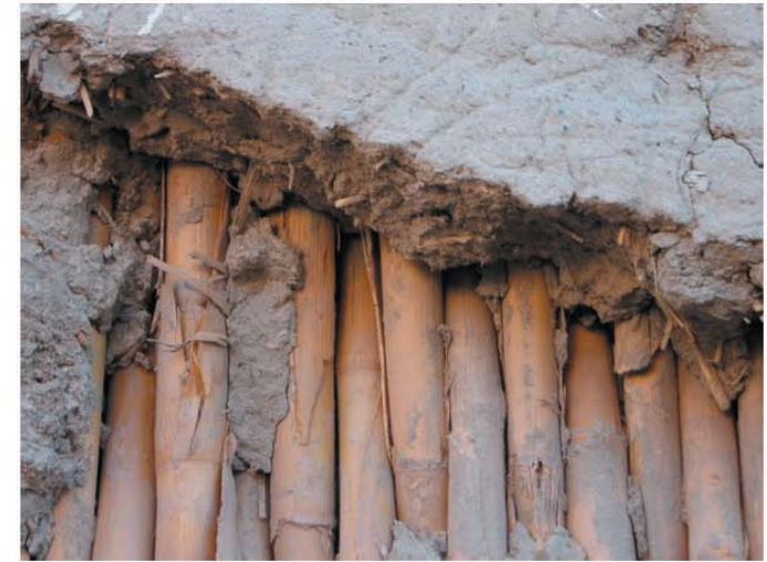
fig 187 Detalle de construcción en Quincha . se aprecia la caña y su revestimiento en tierra o adobe.
