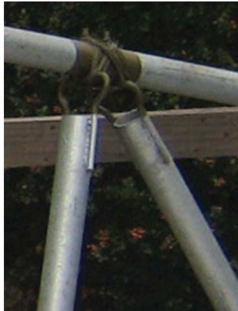
Detalle del embarrilado y fijación de los pilares a la circunferencia metálica, se aprecia la manera en que se adapta la forma del estribo al anillo.
