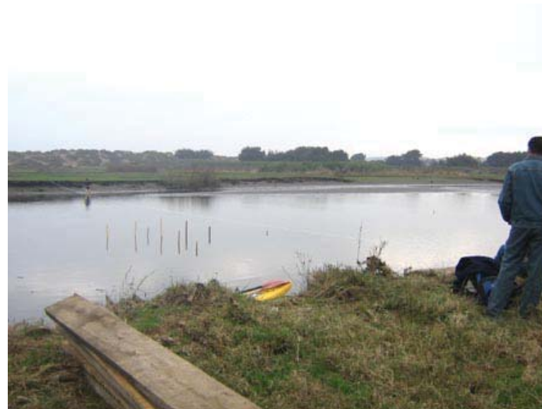
Luego se procede a clavar las demás estacas para tener una noción de las dimensiones de la roca con respecto al estero y sus orillas, para finalmente, trazar el EJE PRINCIPAL del puente.
