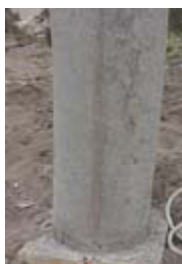
Leve deformación hacia lado derecho de la matriz.
