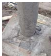
Terminación de Losa sin resolver.
