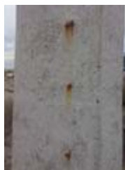
Marcas de óxido.
