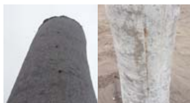
Marcas de óxido.
