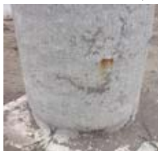
Marcas de óxido y de brocal inferior.
