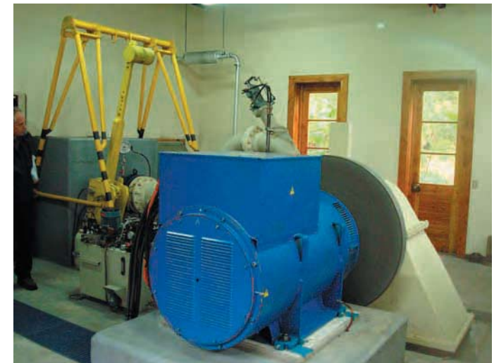
Mini central eléctrica, fundación Huinay
