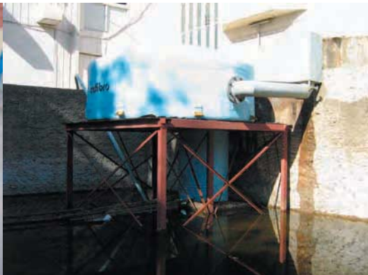
Tanque almacenador externo
