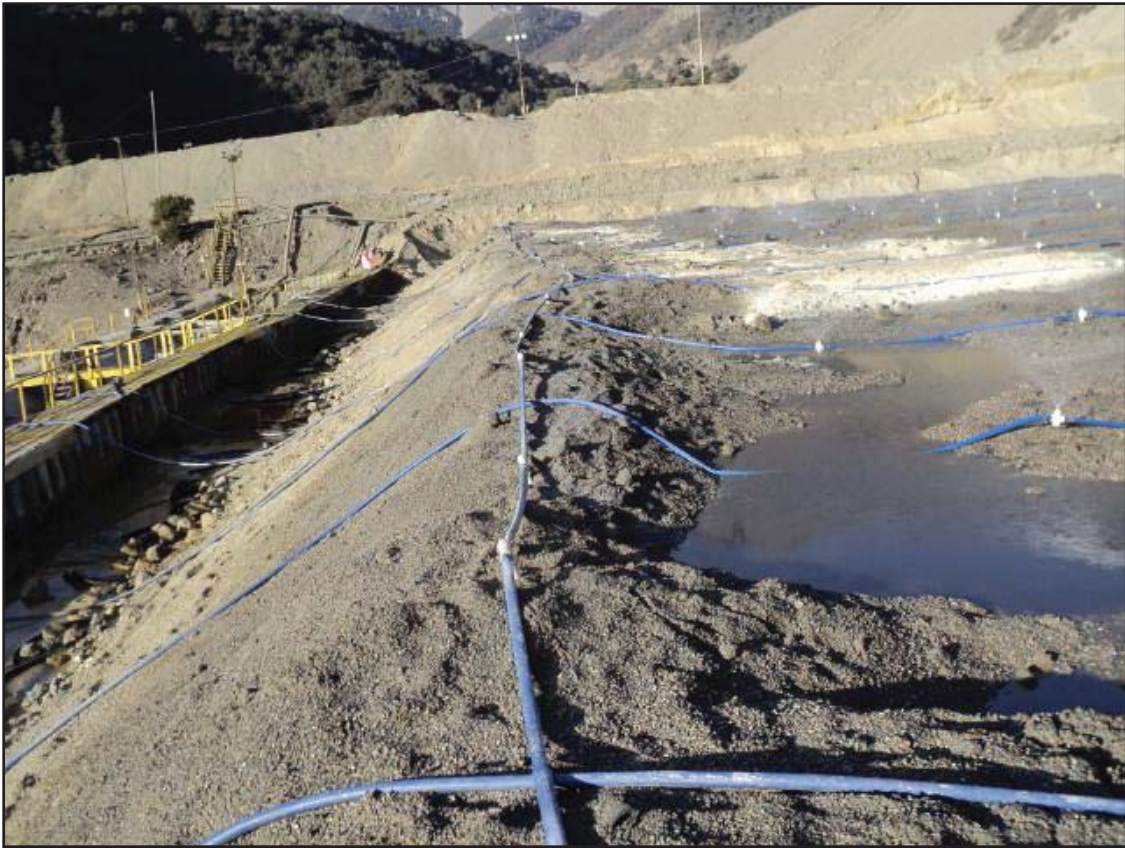
Figura 11. Líneas de riego de talud
