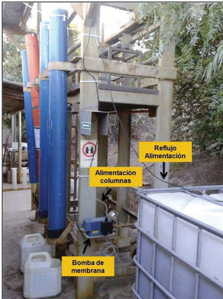
Figura 15. Vista general columnas con líneas de alimentación y refluo.
