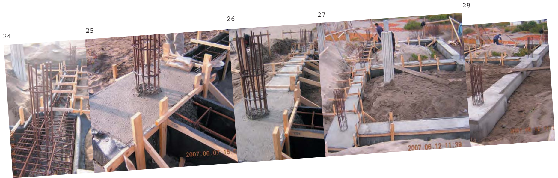
24- Antes de hormigonar se instalan unos fierros para posteriormente desde alli puedan salir los pilares./ 25- Hormigonado de los encepados./ 26- Hormigonado de vigas./ 27,28- Faena finalizada.
