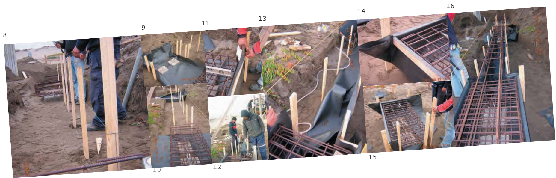
8- Instalacion de las estacas que soportaran al geotextil./ 9- Geotextil para el moldaje de los encepados (uniones entre vigas)./ 10- Postura de los encepados sobre el geotextil. 11,12- El geotextil simplemente se corchetea a la estructura de madera./ 13- Geotextil para vigas./ 14,15- Detalle de las uniones./ 16- Instalacion de la enfierradura de las vigas.
