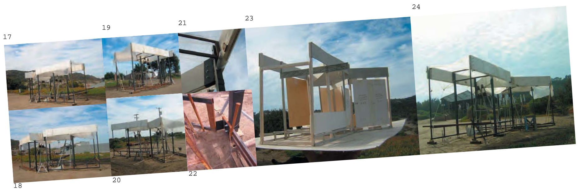
17,18,19,20- Diferentes puntos de vista del habitaculo armado./ 21- Detalle de union superior./ 22- Detalle de union inferior./ 23,24- Maqueta y modulo.
