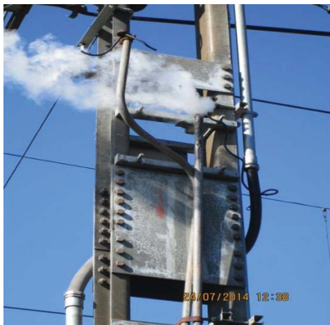
Figura 1-1: Pórtico humeando en sector ex estación Maule – Registro fotográfico Empresa SSEC.
