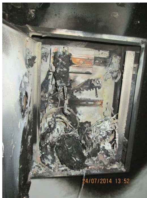
Figura A.5- 8: Elementos y dispositivos dañados (2) – Registro fotográfico Empresa SSEC.
