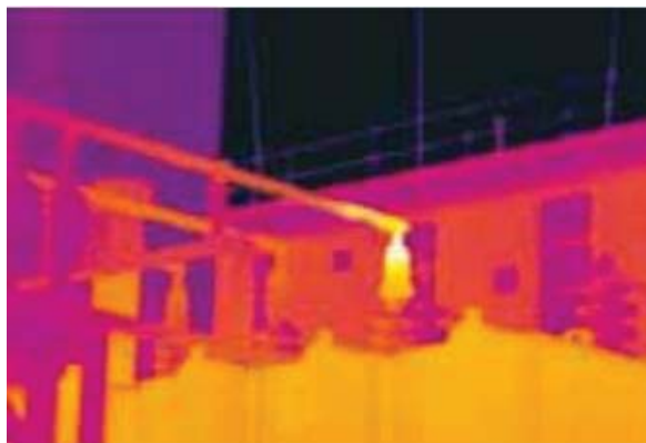
Figura 5-1: Zonas de alta resistencia no deseadas en subestaciones - Guía de termográfica para mantenimiento predictivo, FLIR.
