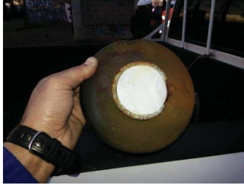
Figura 2-2: Aislador de cerámico retirado luego de falla – Registro fotográfico Empresa SSEC.
