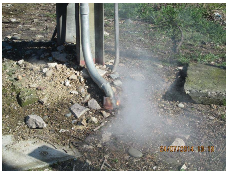
Figura A.5- 3: Bajada tubería y terreno cristalizado – Registro fotográfico Empresa SSEC.
