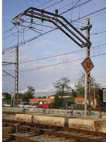
Figura 1-4: Catenaria - Tecnología de la catenaria [16].
