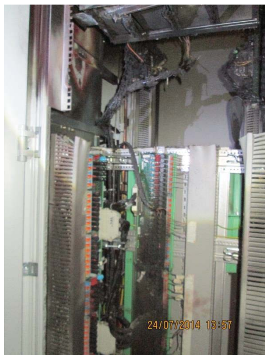
Figura A.5- 10: Elementos y dispositivos dañados (4) – Registro fotográfico Empresa SSEC.
