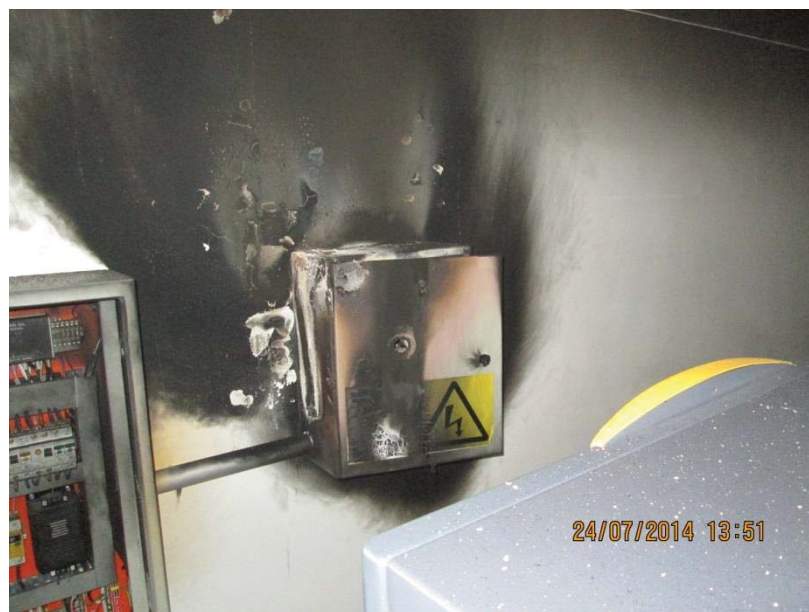
Figura A.5- 7: Elementos y dispositivos dañados – Registro fotográfico Empresa SSEC.
