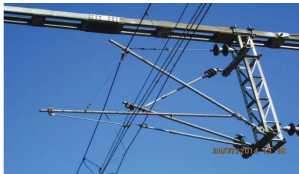
Figura 2-1: Aislador de cerámico en zona de falla – Registro fotográfico Empresa SSEC.
