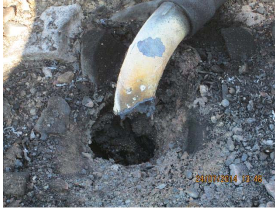
Figura 3-5: Ducto de bajada p rtico, material aluminio – Registro fotogr fico Empresa SSEC.
