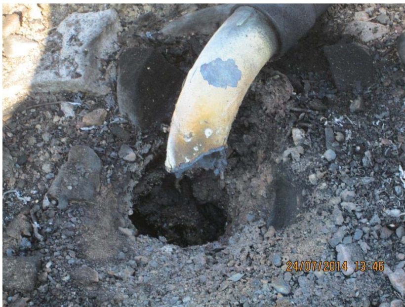
Figura A.5- 4: Bajada de tubería y terreno cristalizado (2) – Registro fotográfico Empresa SSEC.
