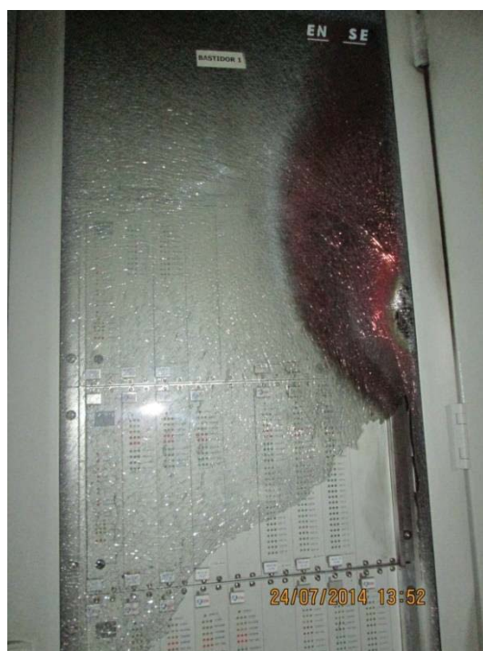
Figura A.5- 9: Elementos y dispositivos dañados (3) – Registro fotográfico Empresa SSEC.
