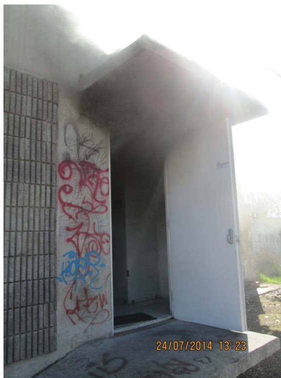
Figura A.5- 6: Entrada local técnico – Registro fotográfico Empresa SSEC.
