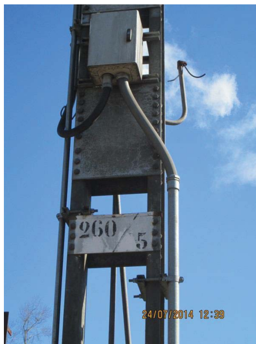
Figura A.5- 2: Estructura pórtico humeando – Registro fotográfico Empresa SSEC.
