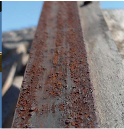
Estado de oxidacion de una obra de no mas de 3 años de exposicion.
