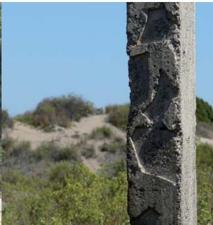
Hitos artificiales que sirven de punto de referencia.
