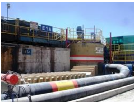
Figura 2-1 Decantadores de SX
