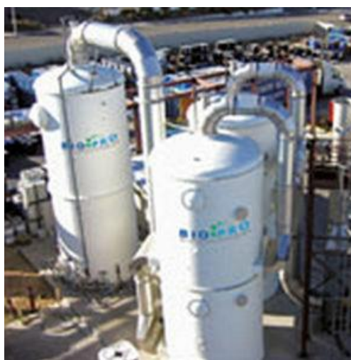
Figura 2-5 Filtros de orgánico SX
