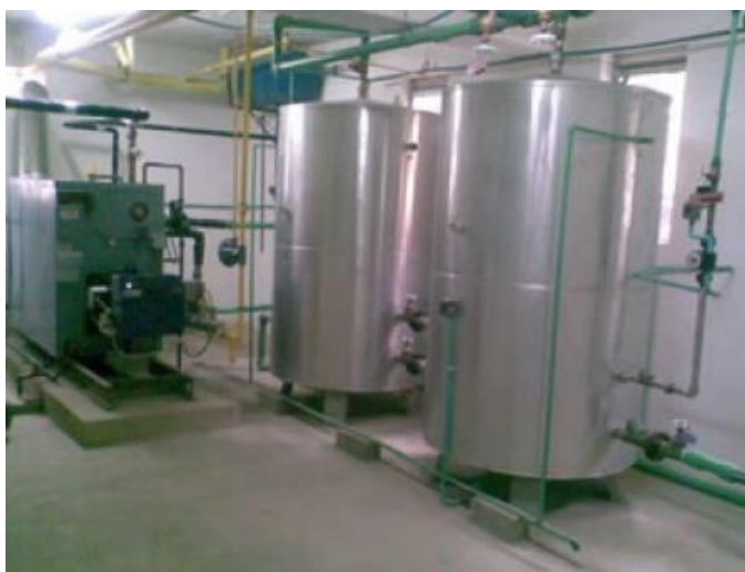
Figura 2-2 Calentadores de agua SX
