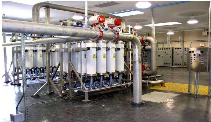
Figura 2.7: Zona de microfiltración en planta Franklin, Boston
