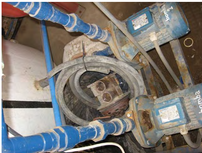
Figura 3.14: Bombas de distribución
