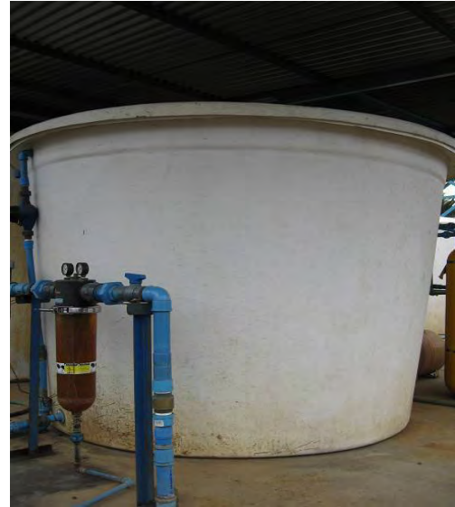
Figura 3.8: Estanque de retención
