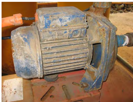
Figura 3.9: Bomba del estanque de retención
