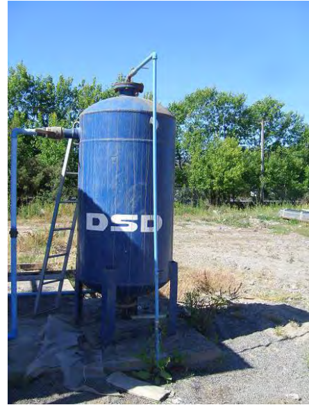
Figura 3.4: Filtro de arena
