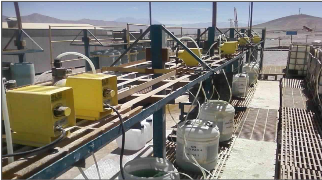
FIGURA 35: Bombas peristálticas instaladas en la estructura de isocontenedores.
