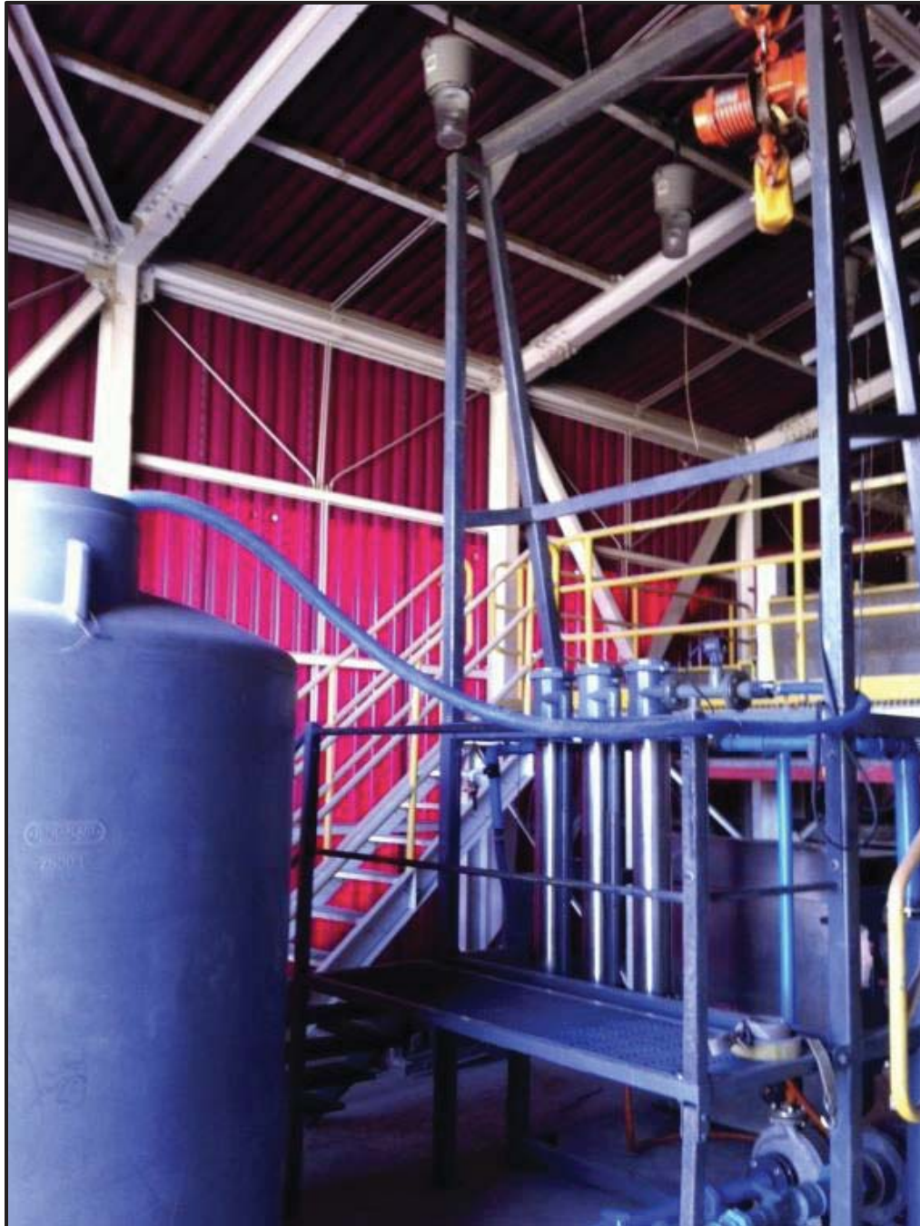
Figura 7.5: Planta Piloto EMEW® instalada en Codelco Radomiro Tomic.
