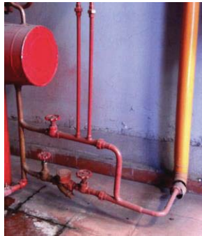
Figura 12. Trampa de vapor del manifold de distribución general de vapor.
