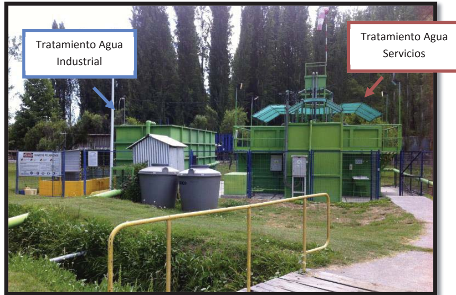
Figura 13. Planta de Tratamiento de Riles en Planta Cachantun.
