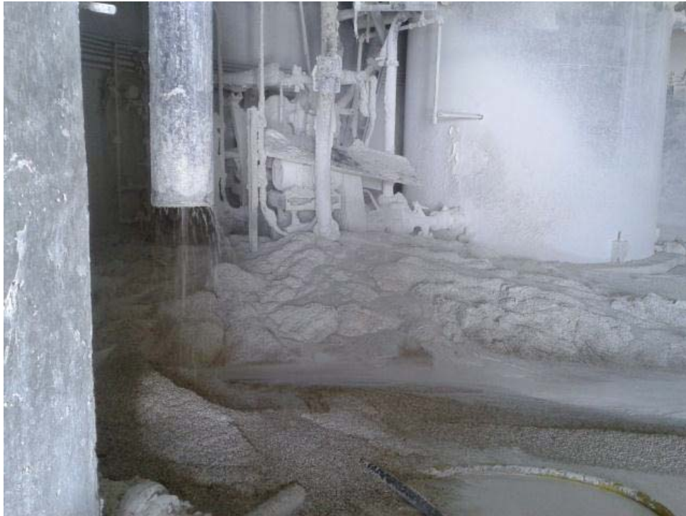
Figura 6.22: Acumulación de rechazo en la planta de cal N°2
