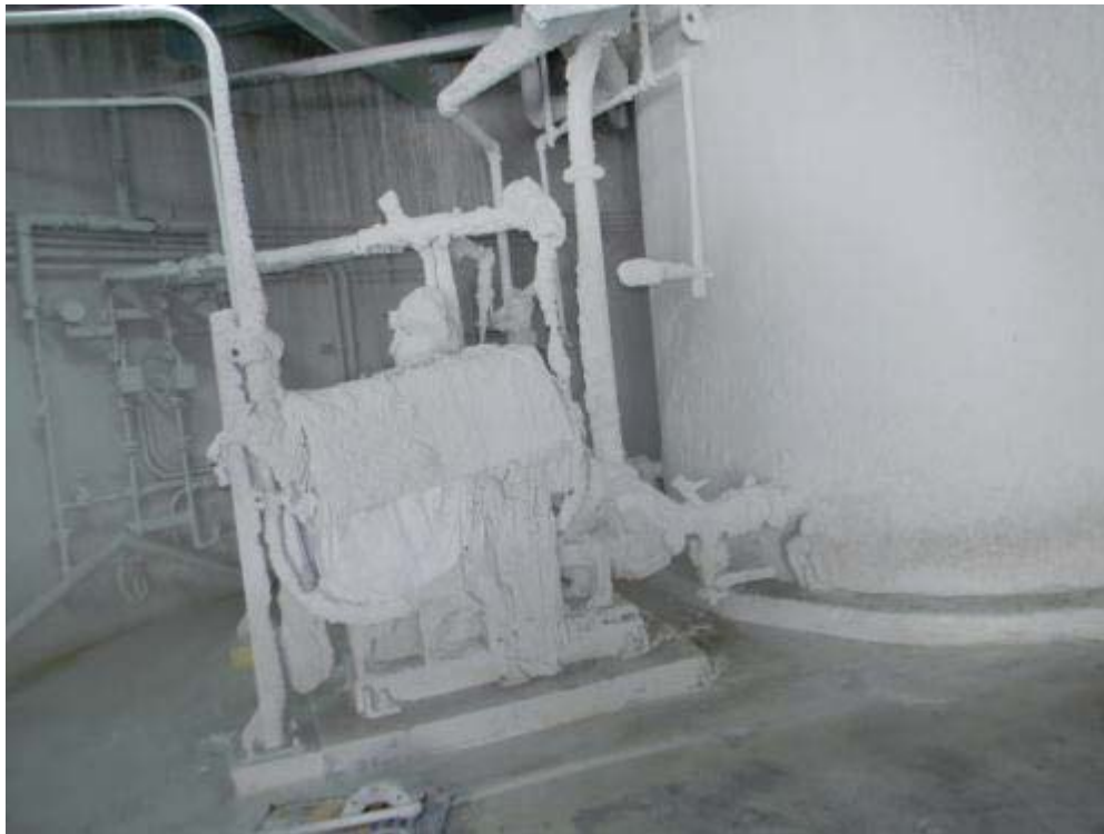
Figura 6.21: Filtraciones específicas en la planta de cal N°2
