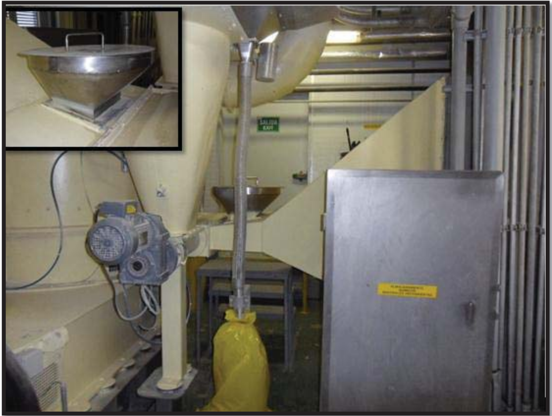
Figura 32. Vista interna de la toma del aire en el área 14, con acercamiento de la tolva a reemplazar para la prueba.
