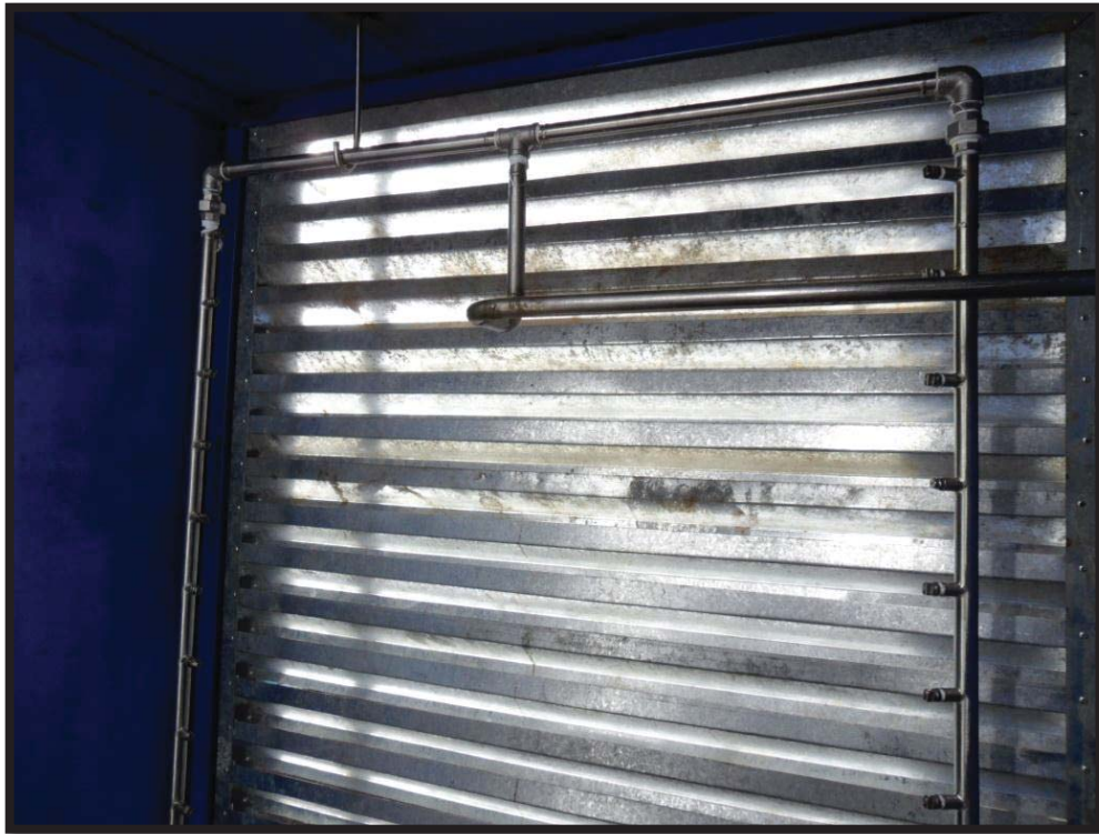
Figura 26. Fotografía del arco de aspersores montado en el interior de la pre-cámara.
