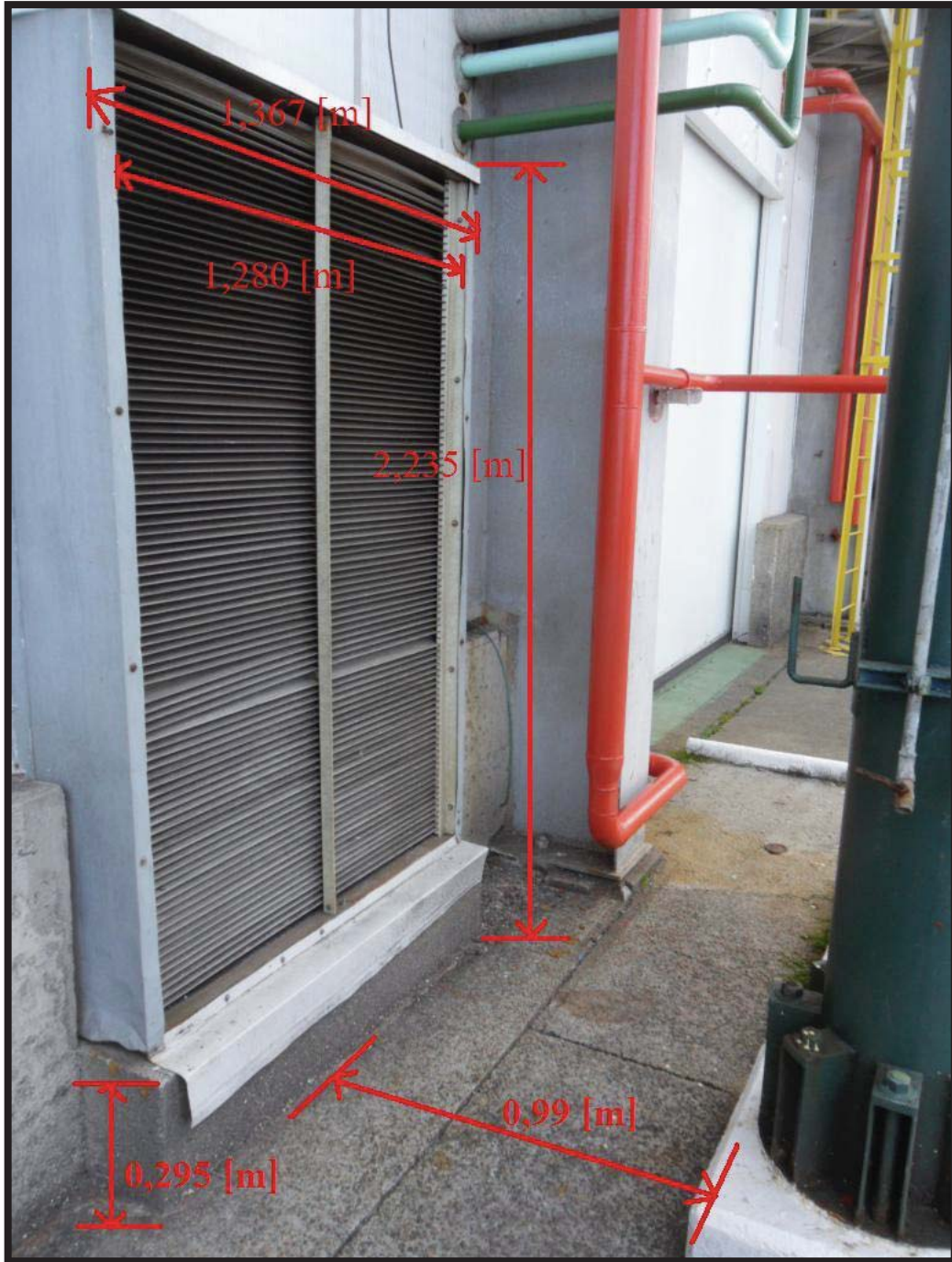
Figura 24. Fotografía de la parte externa de la toma de aire, con las medidas del espacio libre expresadas.
