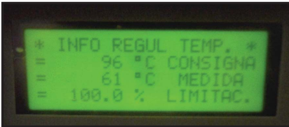
Figura 41. Pantalla del PLC del molino. Muestra la temperatura actual del molino de 61 °C.
