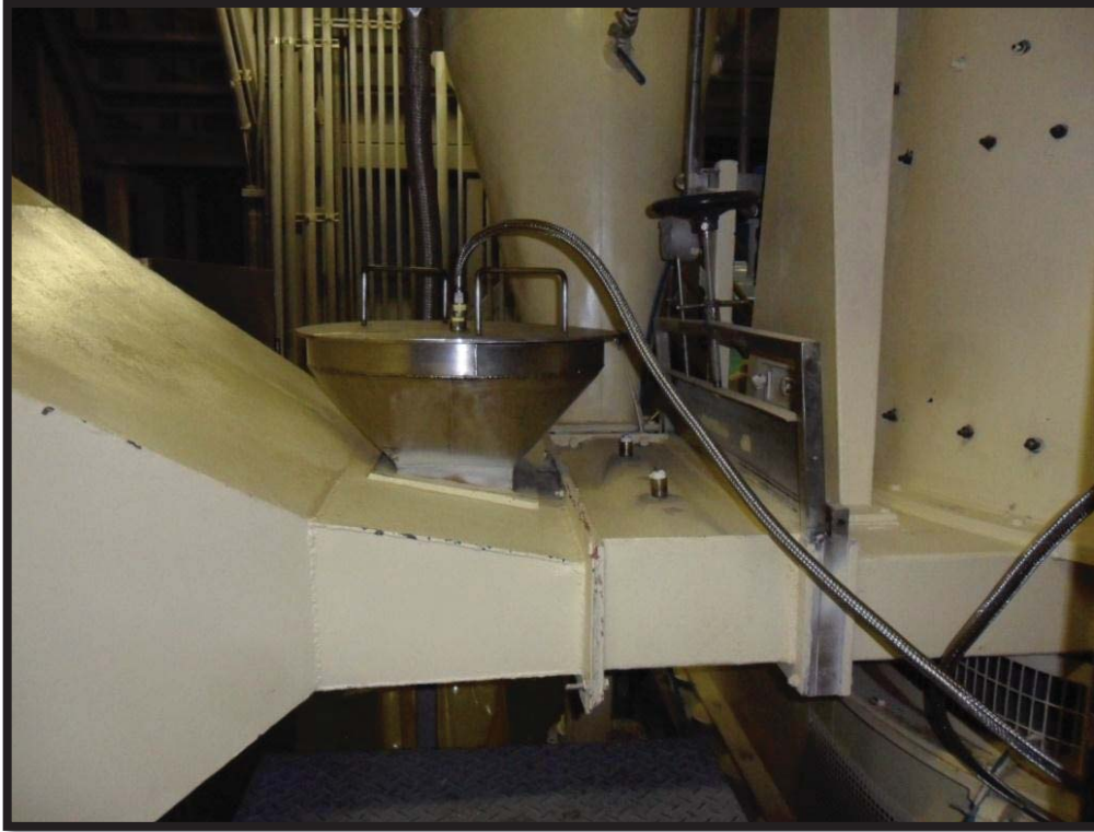
Figura 40. Tapa de prueba con flexible conectada al sistema.
