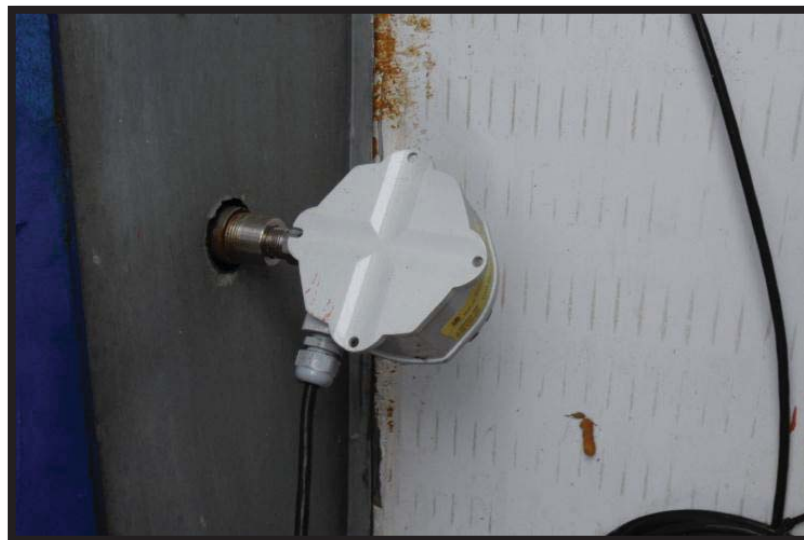
Figura 17. Transmisor de temperatura en la toma de aire.
