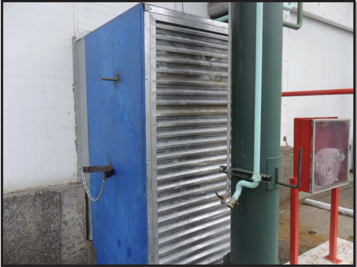
Figura 25. Fotografía de la pre-cámara instalada en la toma de aire del molino principal.
