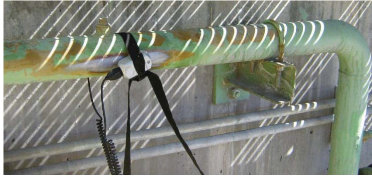
Figura 3.6: Medición Make-up circuito secundario
