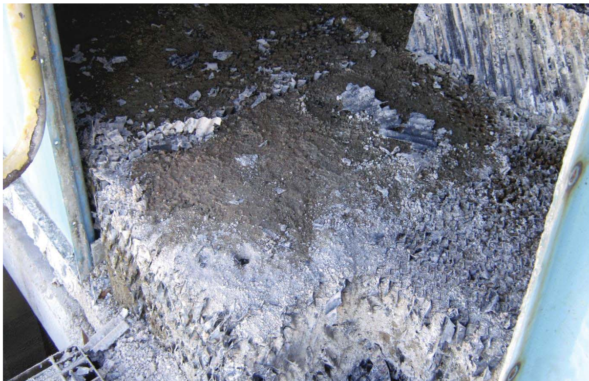
Figura 3.7: Estado de Relleno Torres de Enfriamiento.
