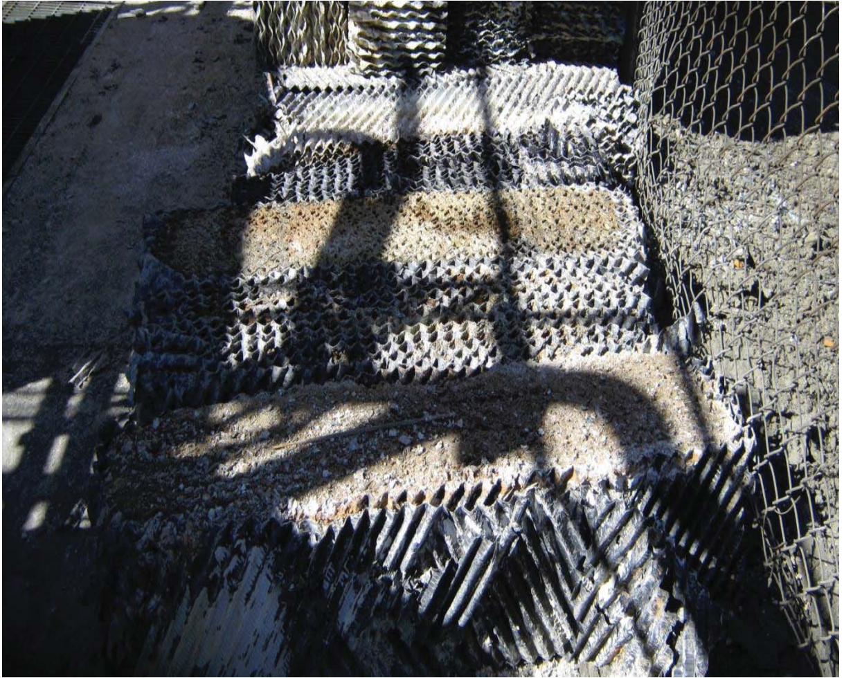
Figura 3.8: Relleno Torres de Enfriamiento
