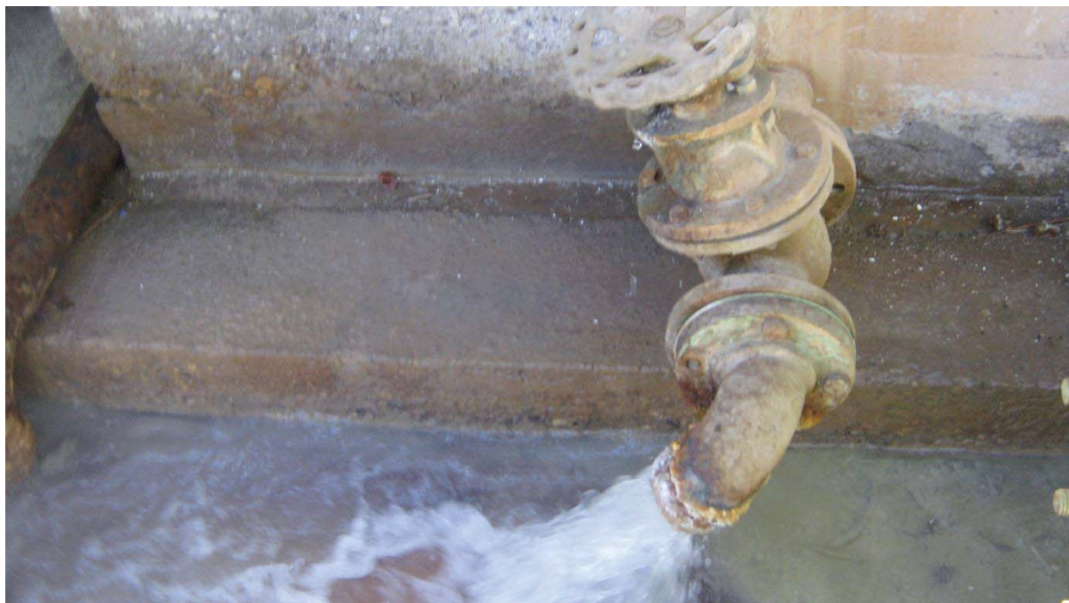
Figura 3.12: Purga Circuito Primario.
