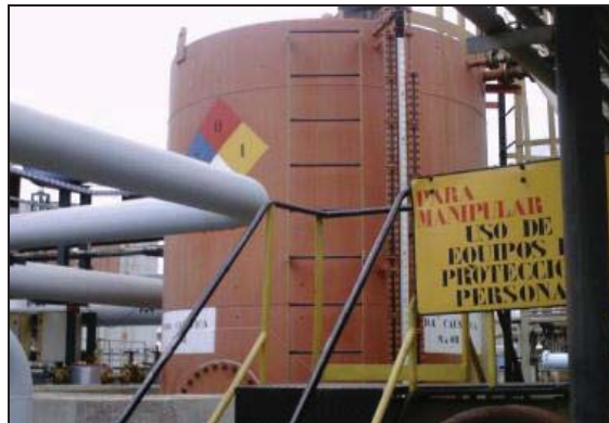
Figura 21: Estanque Soda Cáustica (F-260)
