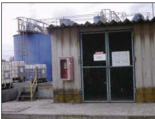
Figura 22: Sala de Dosificación Química
