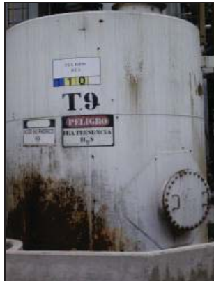
Figura 28: Estanque de DEA sobre piso
