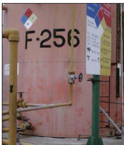
Figura 20: Estanque Acido Sulfúrico (F-256)
