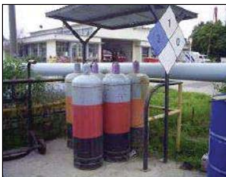
Figura 31: Centro de Acopio de Gases Comprimidos y Viscorredutora
