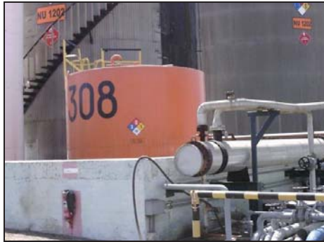
Figura 10: Estanque de Soda T-308
