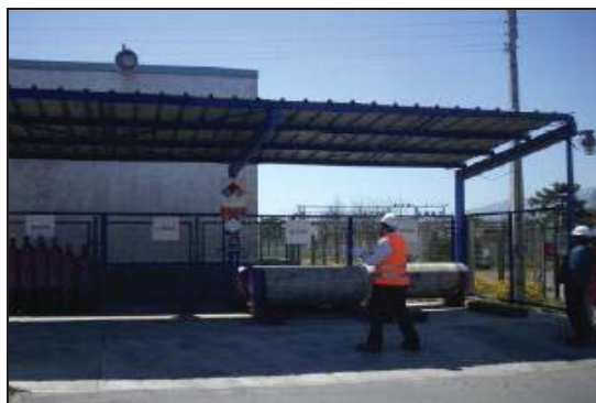
Figura 19: Almacenamiento de Cloro
