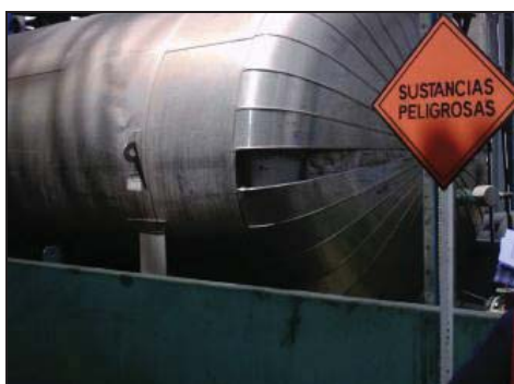
Figura 25: Estanque Mejorador de Lubricidad
