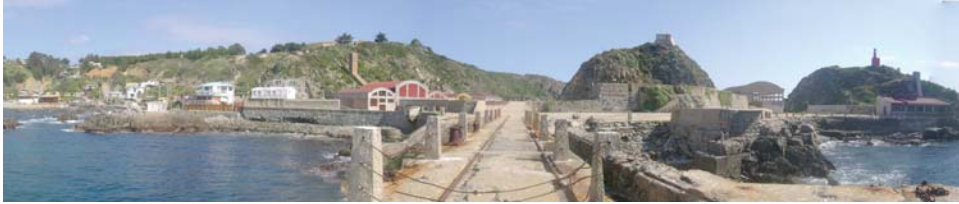
6º RAMPA. de arrastre de ballenas desde el mar, de 15x4 mts en mal estado
