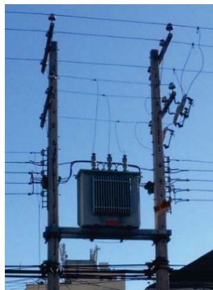
Figura 4-1: Transformador distribución de dos zonas [Fuente: Propia].
