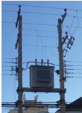
Figura 1-5: Líneas primarias, secundarias y transformador de distribución [Fuente: Propia].
