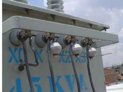
Figura 1-9: Apartarrayos en transformador de distribución [11].
