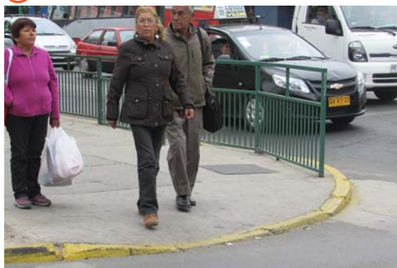
fig. 127 El ancho del rebaje se cumple, pero no existe Huella Podotáctil, ni tampoco el rebaje llega al nivel del 0 entre la vereda y la calzada.
