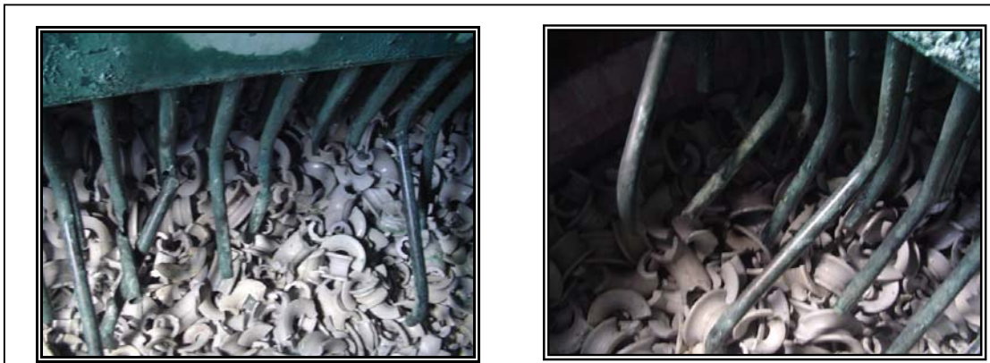
Figura 6.3.- Distribuidor SARAMET 23 dañado Mantenimiento año 2006.
