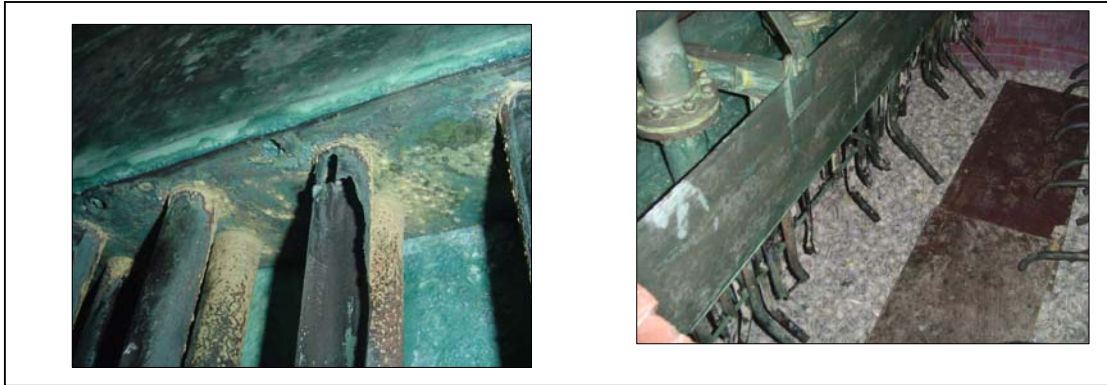
Distribuidor SARAMET 23. Mantenimiento año 2005
