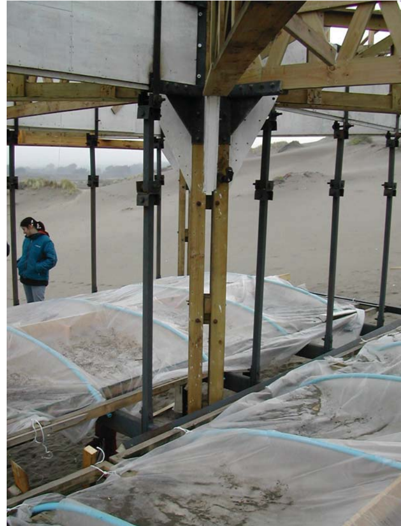
VISTA INTERIOR. / DETALLE DE REFUERZO ESTRUCTURAL PARA ENCUENTRO DE VIGAS Y PILAR CENTRAL
