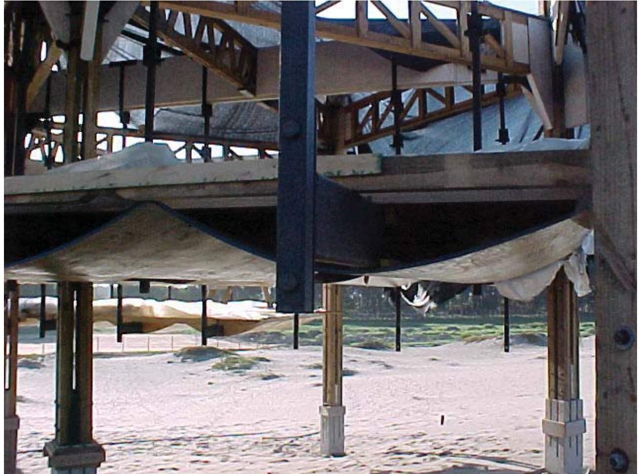
VISTA GENERAL EXTERIOR MÓDULOS DE SUELO
