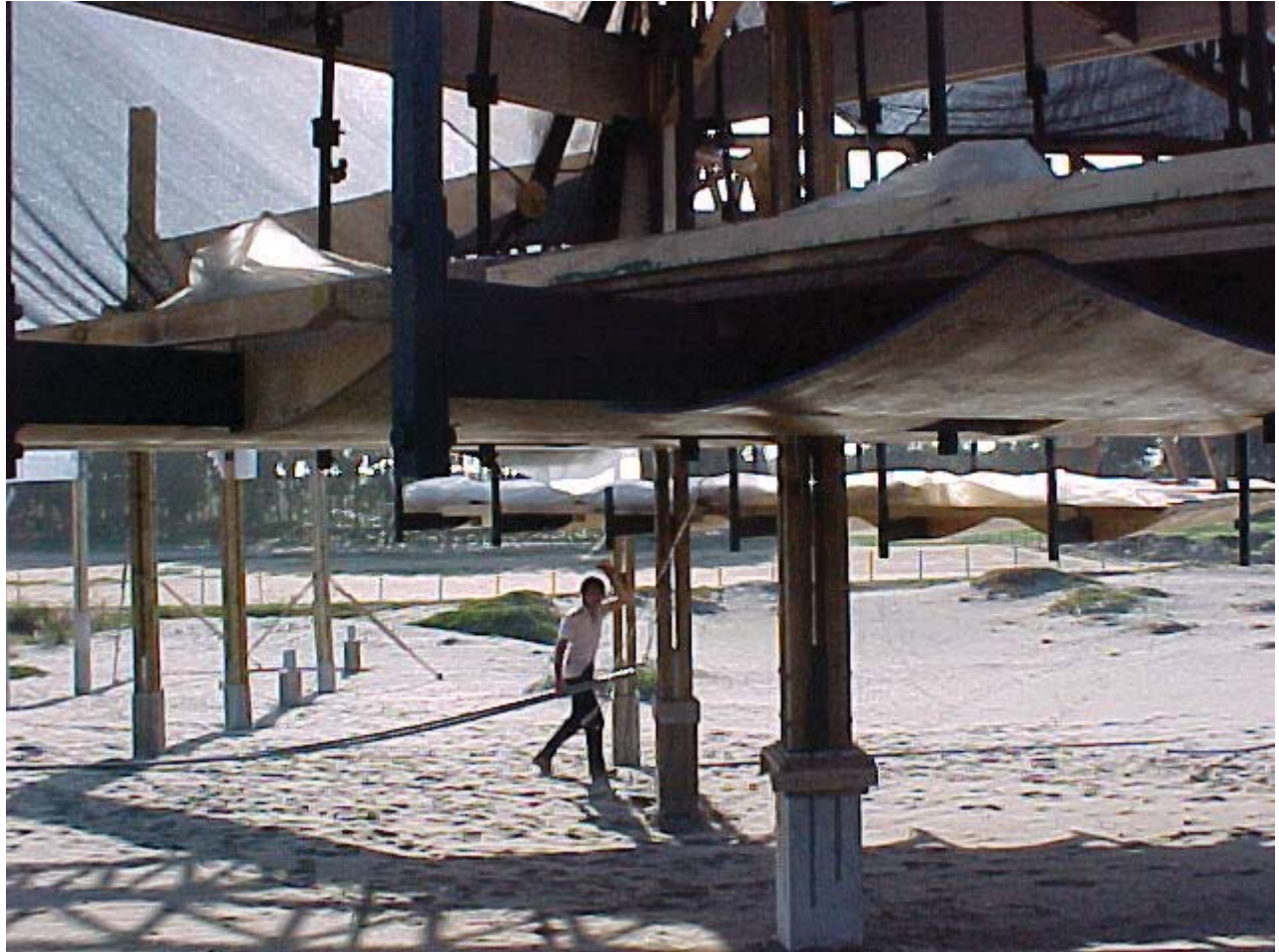
VISTA GENERAL EXTERIOR MÓDULOS DE SUELO
